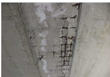
Рис. 3. Отсутствие защитного слоя бетона
