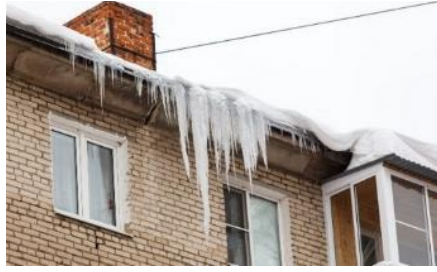
Рис. 2. Сосульки на карнизном свесе крыши
