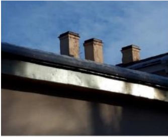
Рис. 1. Наледь на холодном участке карнизного свеса
