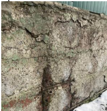
Рис. 1. Биоповреждение (мхи и плесень) бетонной конструкции
