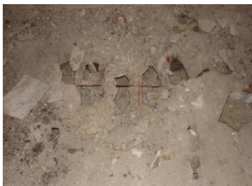
Рис. 1. Разрушение верхней полки плиты перекрытия
