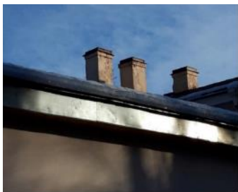
Рис. 1. Наледь на холодном участке карнизного свеса
