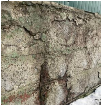
Рис. 1. Биоповреждение (мхи и плесень) бетонной конструкции
