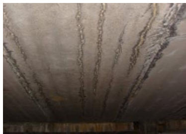
Рис. 2. Продольные трещины на нижней полке плиты перекрытия
