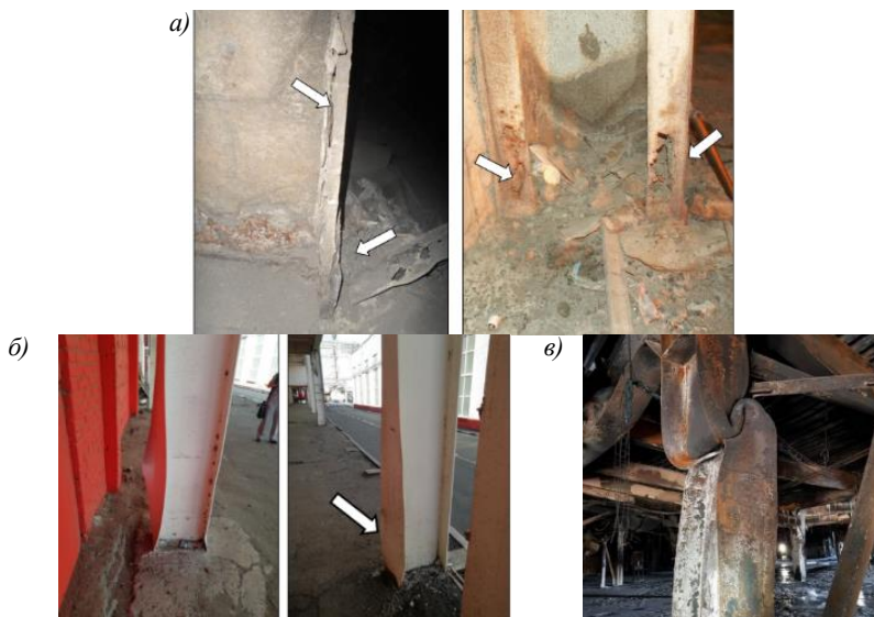
Рис. 1. Повреждения, возникшие в ходе эксплуатации: а – слоистая коррозия; б – погиб полки колонны двутаврового сечения; в – повреждение колонны от термического воздействия (вследствие пожара)
