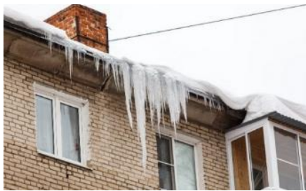
Рис. 2. Сосульки на карнизном свесе крыши
