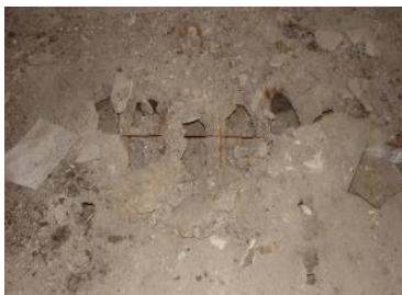
Рис. 1. Разрушение верхней полки плиты перекрытия
