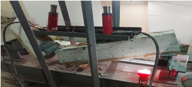
Рис. 6. Внешний вид железобетонного элемента после разрушения
