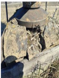
Рис. 2. Оголенная арматура фундамента
