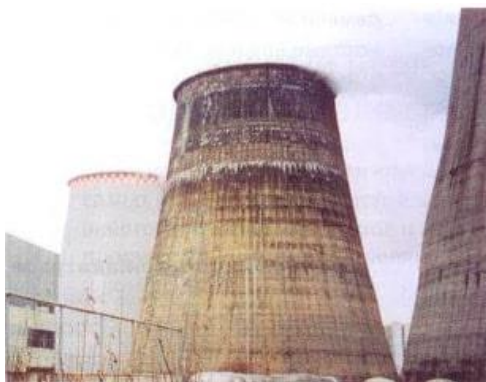
Рис. 1. Железобетонная башенная градирня с признаками термической коррозии [3]
