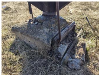
Рис. 3. Разрушенный бетон в фундаменте
