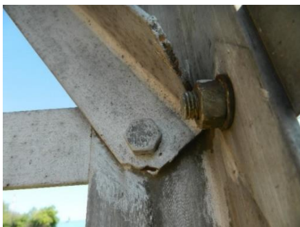
Рис. 2. Отсутствие контргайки и шайбы под шляпкой болта в местах соединения раскосов и поясов мачты
