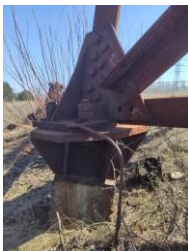
Рис. 1. Трещины в фундаменте
