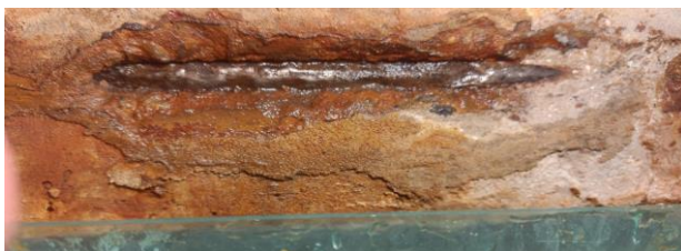
Рис. 5. Внешний вид арматуры растянутой зоны после 32 сут нахождения в агрессивной среде с использованием источника питания
