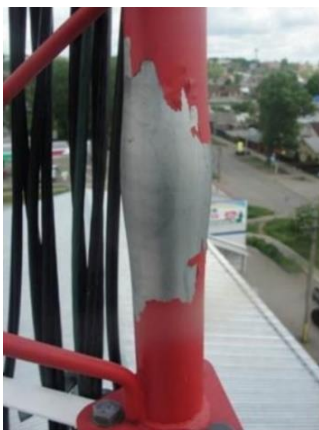
Рис. 1. Деформация пояса мачты с нарушением лакокрасочного покрытия
