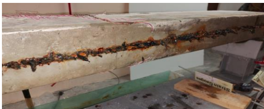
Рис. 4. Внешний вид нижней грани железобетонного элемента после 32 сут нахождения в агрессивной среде с использованием источника питания
