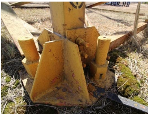
Рис. 3. Отсутствие гидроизоляции фундамента башни
