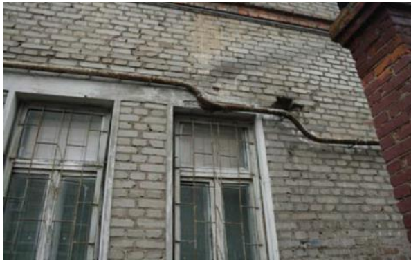
Рис. 3. Разрушение кладки наружных кирпичных стен здания
