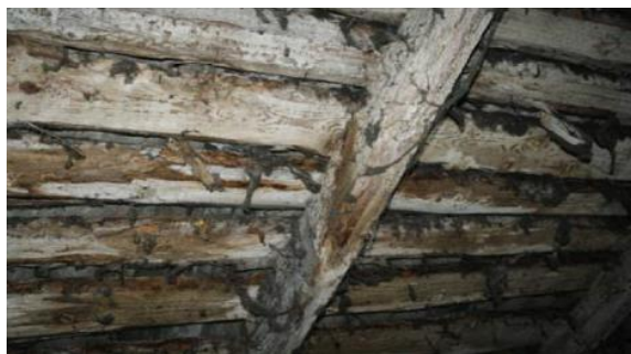
Рис. 4. Поражение гнилью древесины деталей крыши
