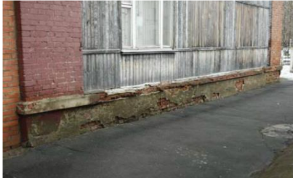
Рис. 2. Разрушение отделочного слоя цоколя здания, биологическое поражение
