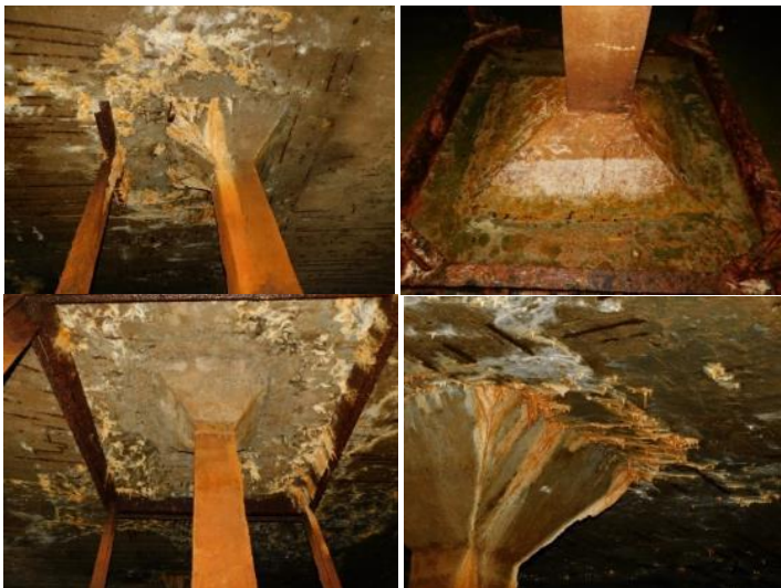
Рис. 3. Техническое состояние колонн и капителей
