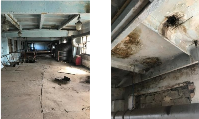
Рис. 1. Состояние строительных конструкций здания ПАВ
