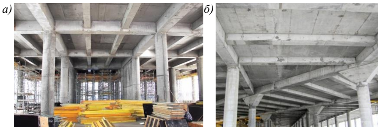
Рис. 1. Монолитное ребристое перекрытие: a – со взаимно перпендикулярными ребрами; б – с разнонаправленными ребрами
